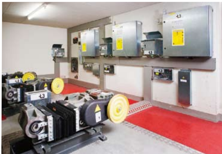
Instalace řízení Schindler a pohon SGB 142 v provedení triplex v budovách komerčního charakteru.
